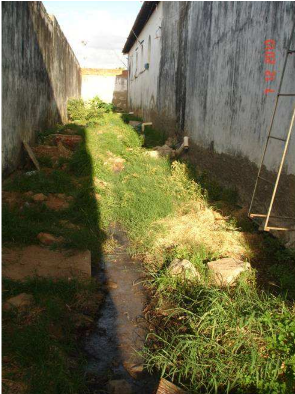
Esgoto ao céu aberto percorrendo toda a área lateral da cela destinada aos presos em regime semiaberto
