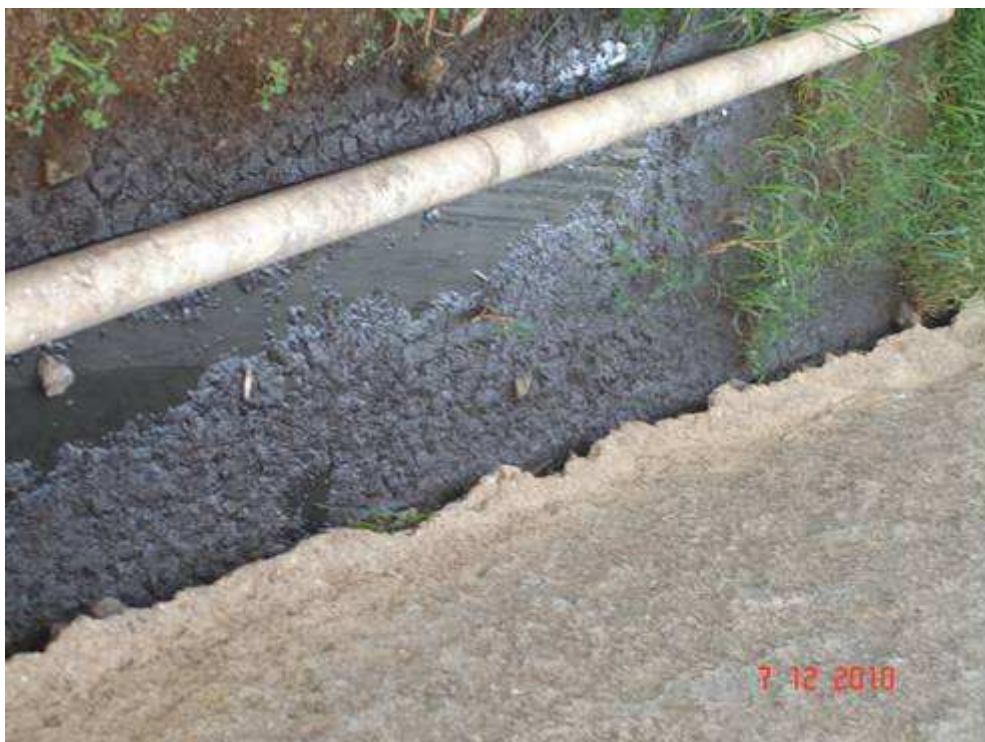
Esgoto ao céu aberto
