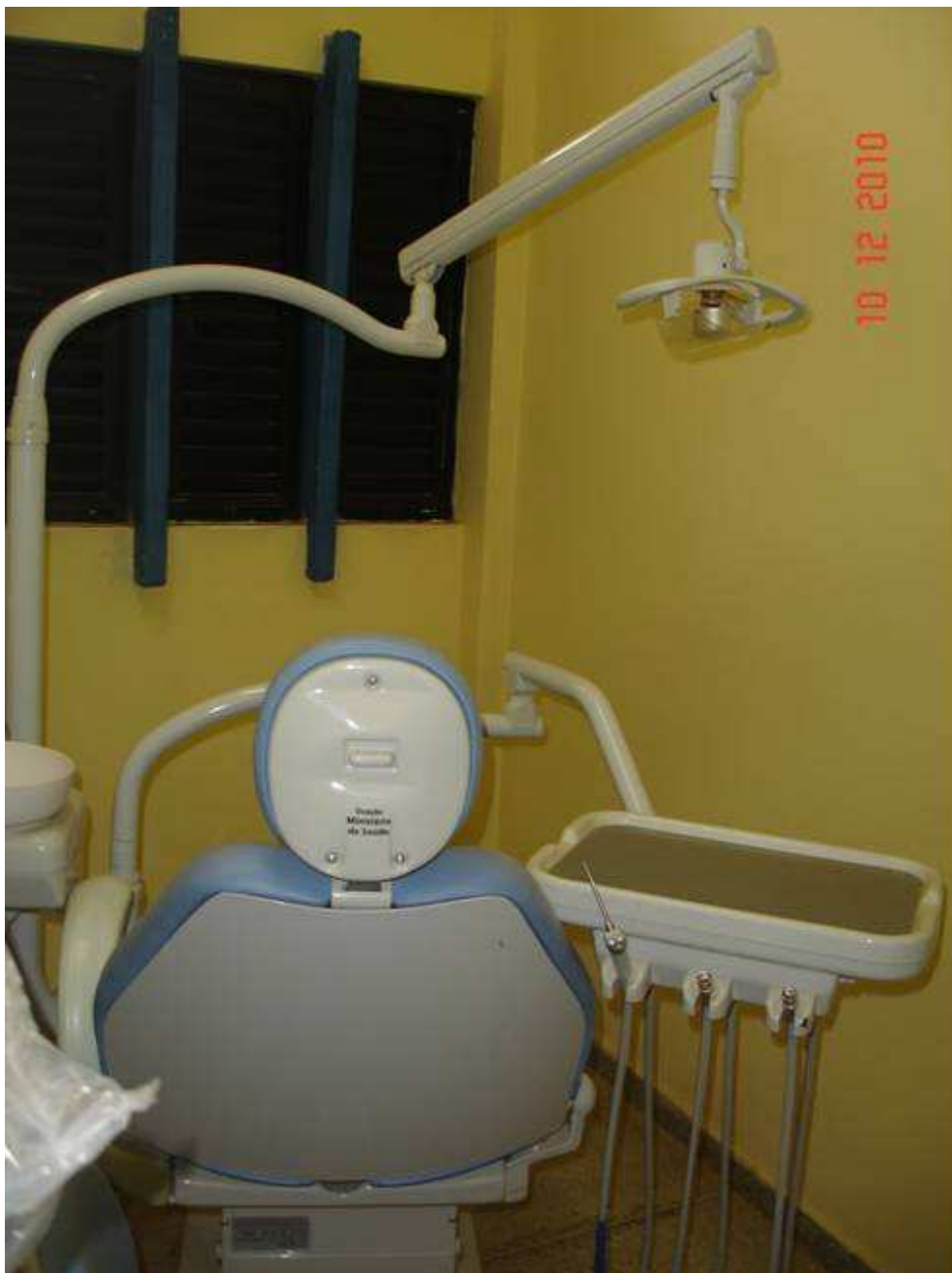
Gabinete odontológico sem funcionamento por ausência de profissionais
