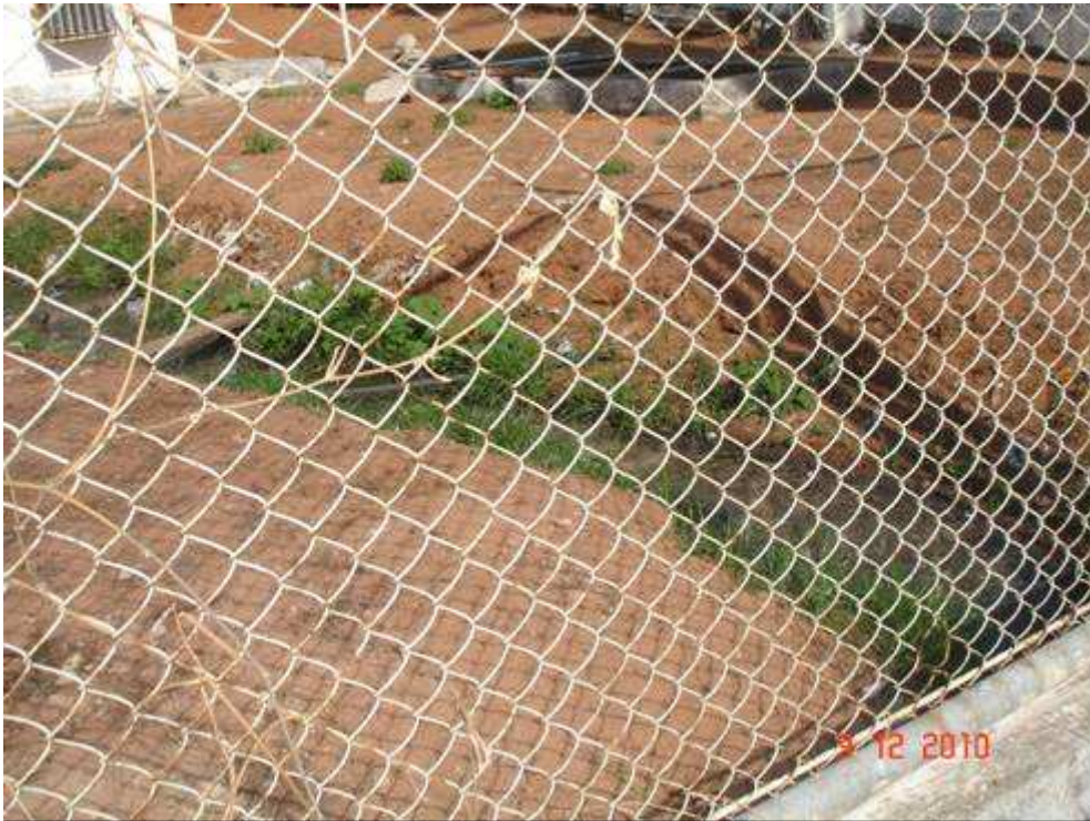
Esgoto ao céu aberto
