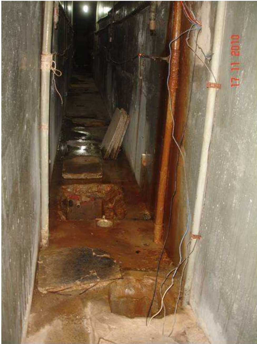
Sistema elétrico e hidráulico sem qualquer condição de segurança
