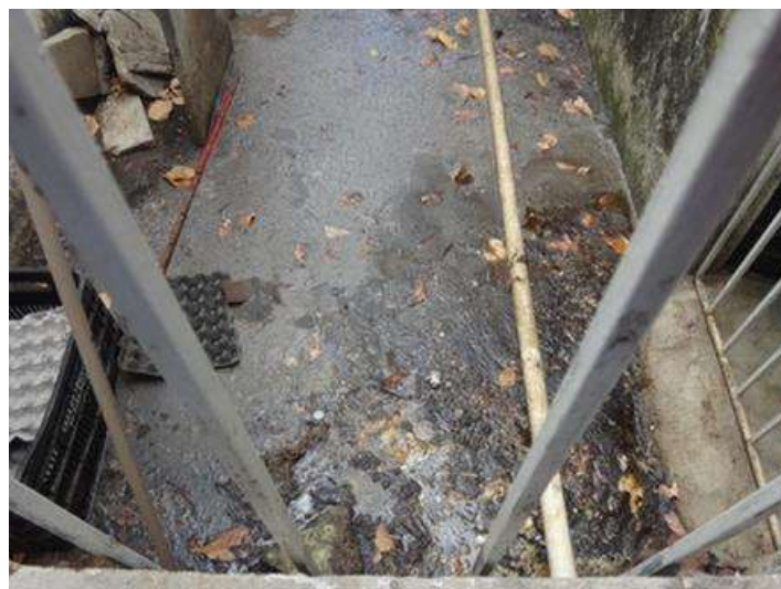
Esgoto acumulado ao lado da cozinha da unidade
