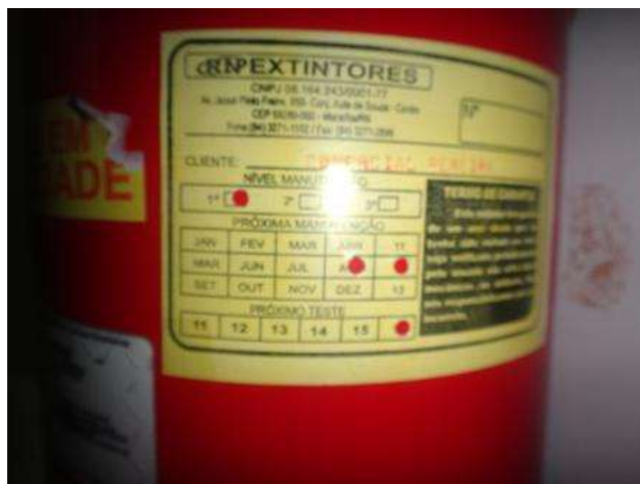
Extintor vencido há quase um ano
