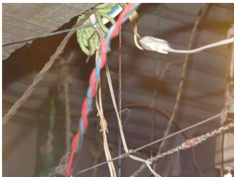
Fiação no interior da cela
