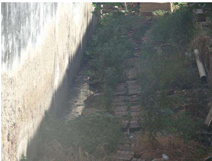
Esgoto ao céu aberto nas mesmas condições da inspeção realizada em 2010
