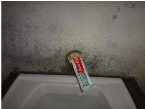
Instalações hidráulicas danificadas.
