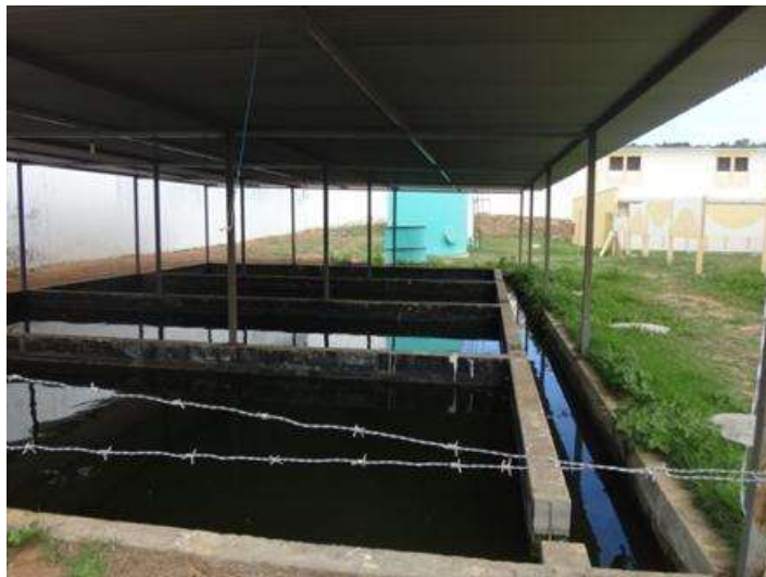
Estação de tratamento de esgoto estragada
