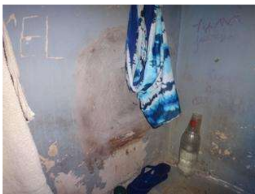
Buracos nas celas recentemente tapados
