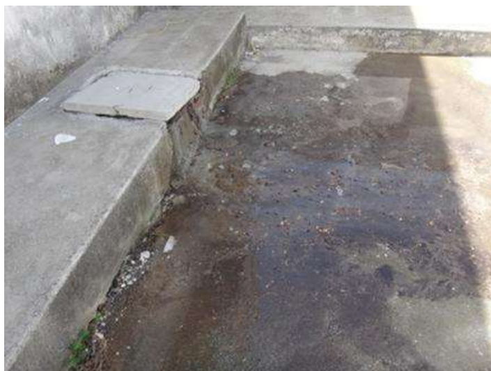
Esgoto e dejetos humanos que correm pela unidade e alcança a calçada e rua.
