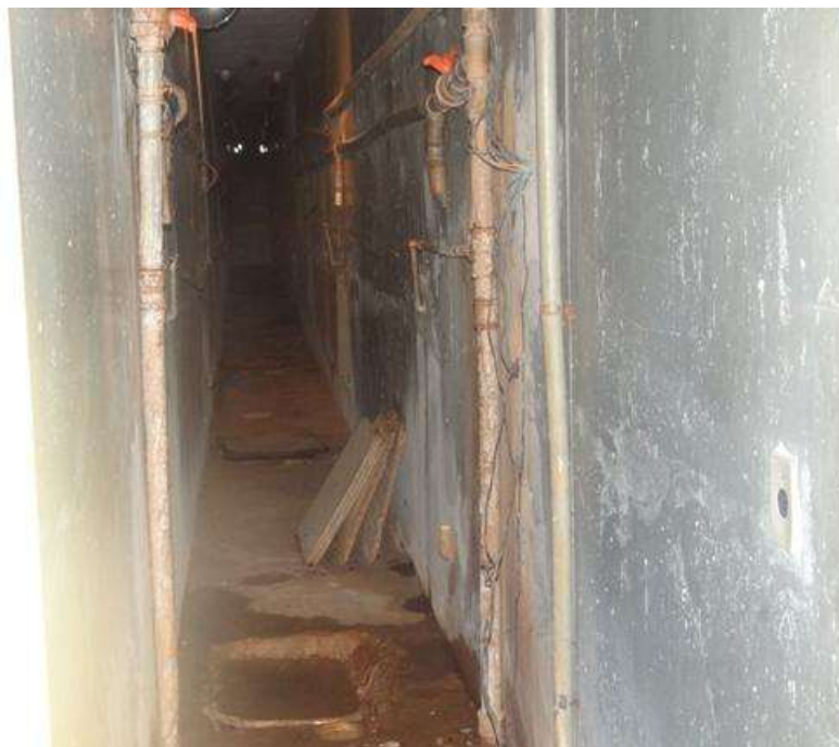
Instalações de água e luz
