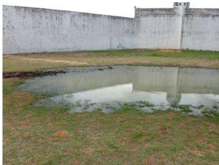
Esgoto a céu aberto
