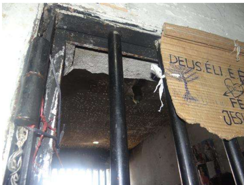
Cela com buracos na laje
