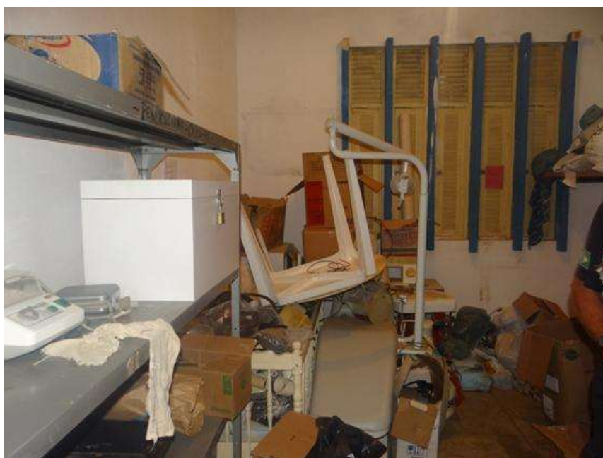
Antigo gabinete odontológico com materiais em escombros
