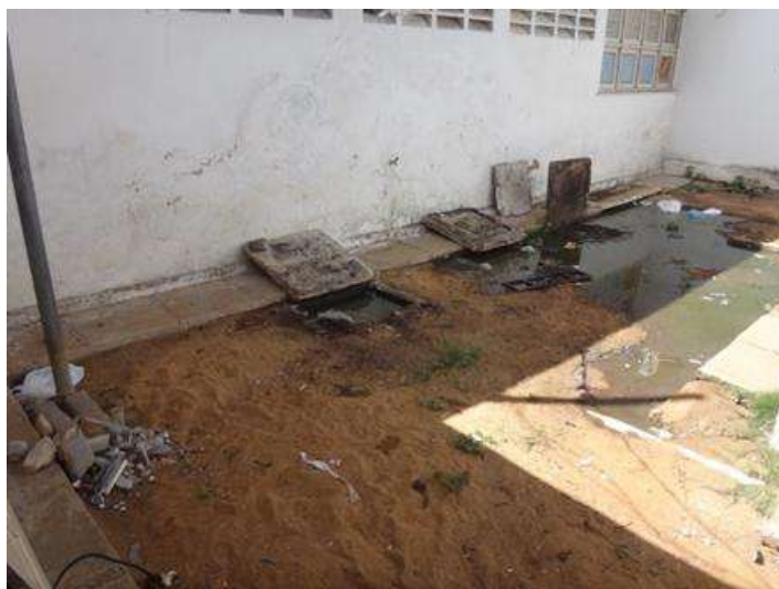
Esgoto a céu aberto dentro da unidade, mau cheiro terrível. Ameaça à saúde.
