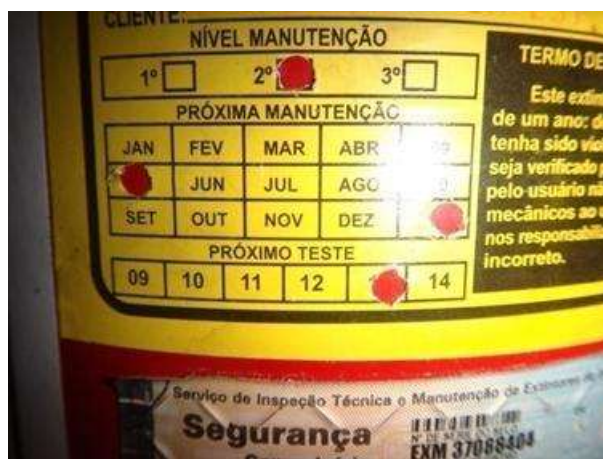
Extintores vencidos e vazios: risco de incêndio e tragédia
