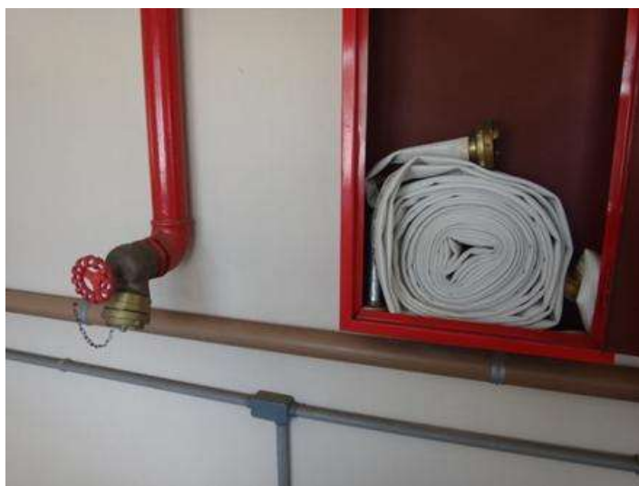
Hidrante em bom estado e completo
