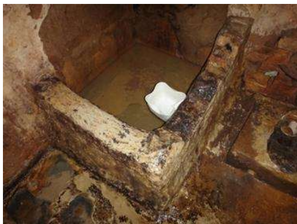
Banheiro fétido e sem funcionamento
