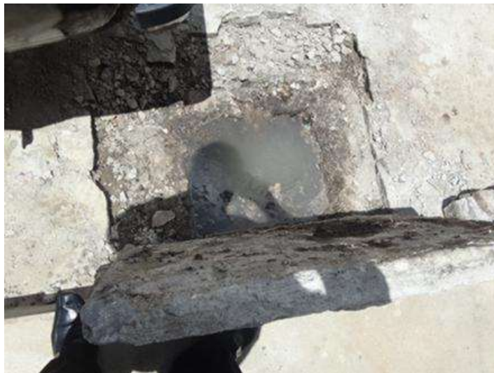
Instalações de esgoto danificadas
