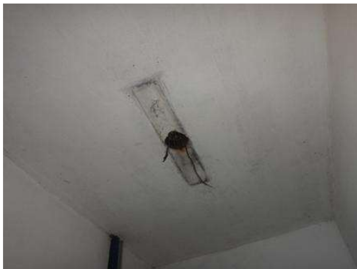
Instalações elétricas inexistentes
