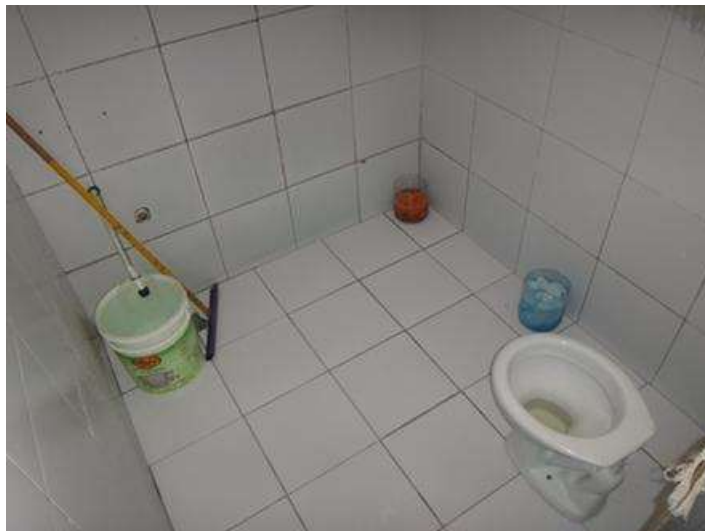
Banheiro: vaso sanitário não tem ligação de água
