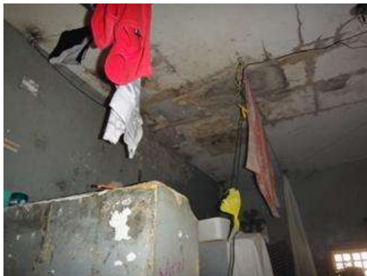
Celas com vários remendos de fugas
