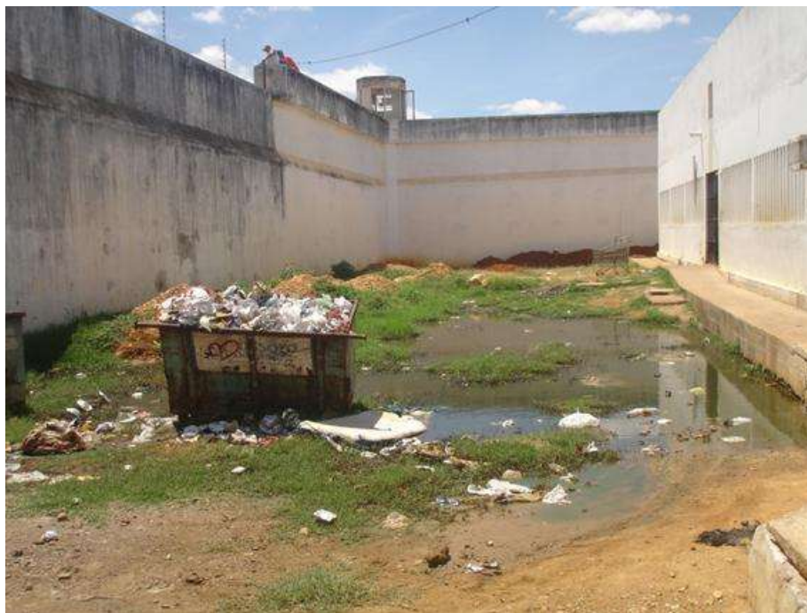
Esgoto ao céu aberto em frente a área da carceragem
