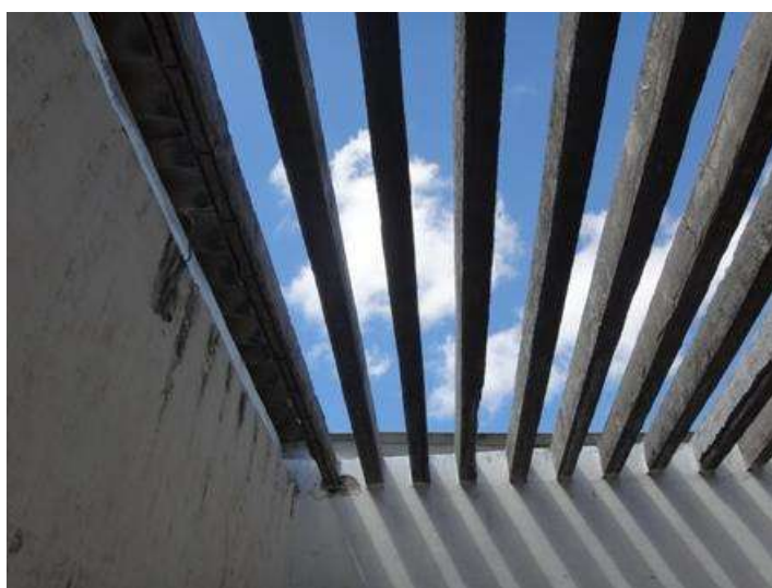
Área de banho de sol que não é utilizada em razão de fugas
