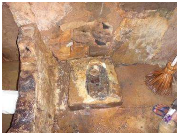
Banheiro em péssimo estado. Sequer funciona. Entupido.
