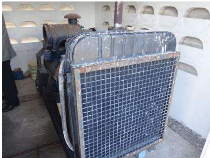
Motor gerador usado no caso de ausência de energia
