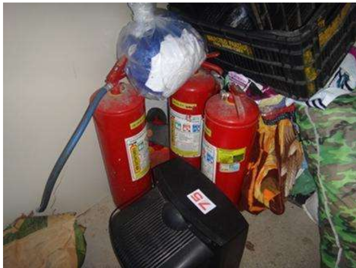
Extintores vencidos e sem utilização
