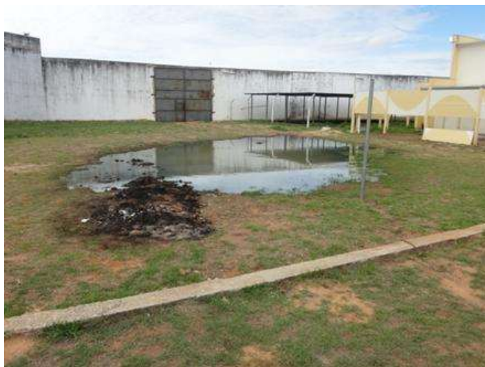
Esgoto a céu aberto: cheiro insuportável
