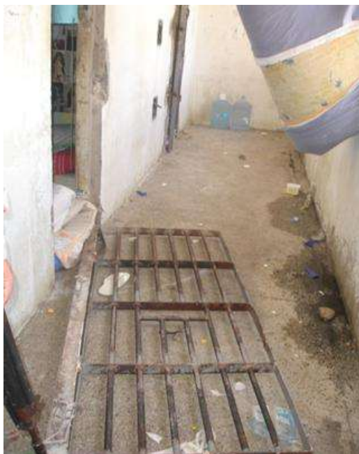
Área da carceragem danificada
