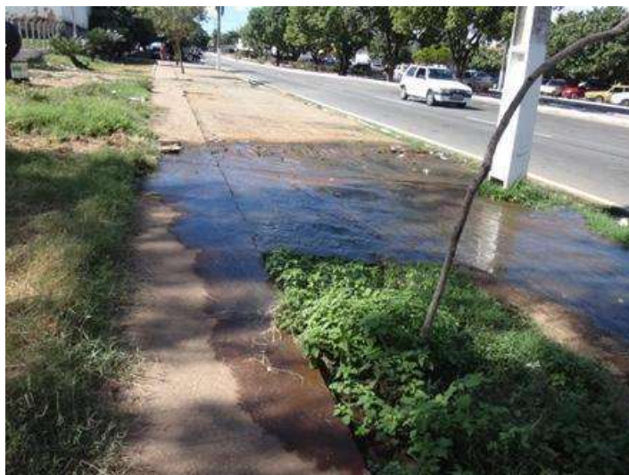
Esgoto do presídio sendo jogado na calçada
