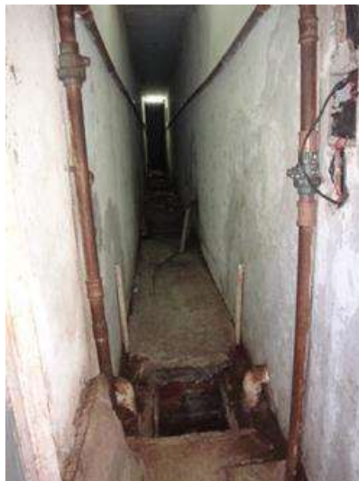
Instalações improvisadas e deficitárias
