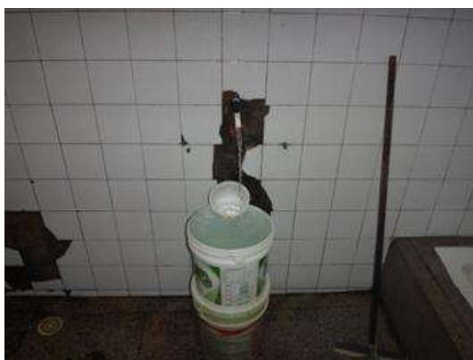
Banheiros com vazamentos
