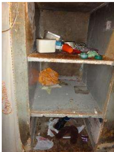
Comida indevidamente armazenada
