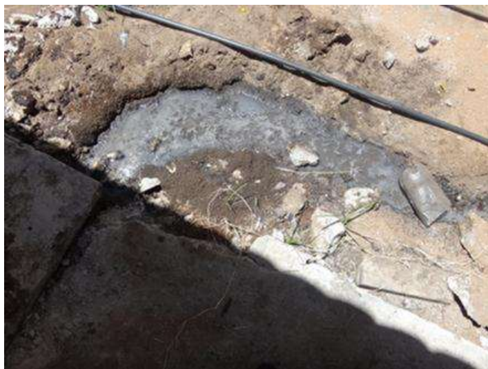
Esgoto a céu aberto
