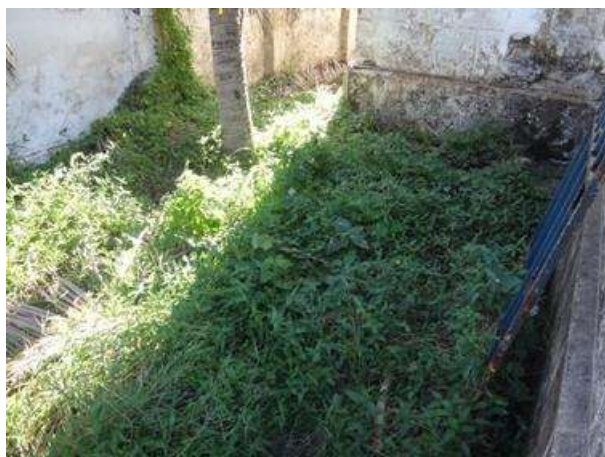
Esgoto vazando da fossa
