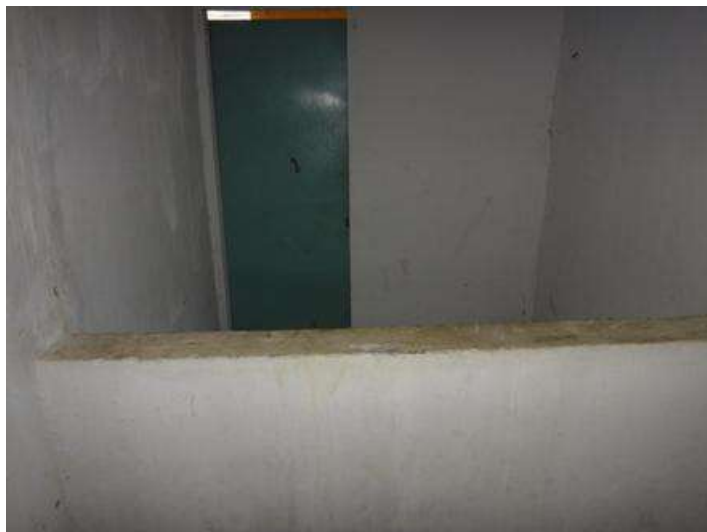
Parlatório (improvisado e inadequado). Não há qualquer divisória.
