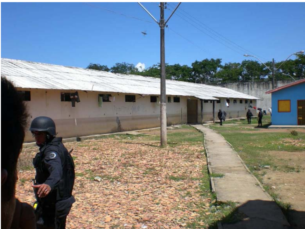
Vista externa de outro pavilhão – veja a fragilidade das paredes e teto
