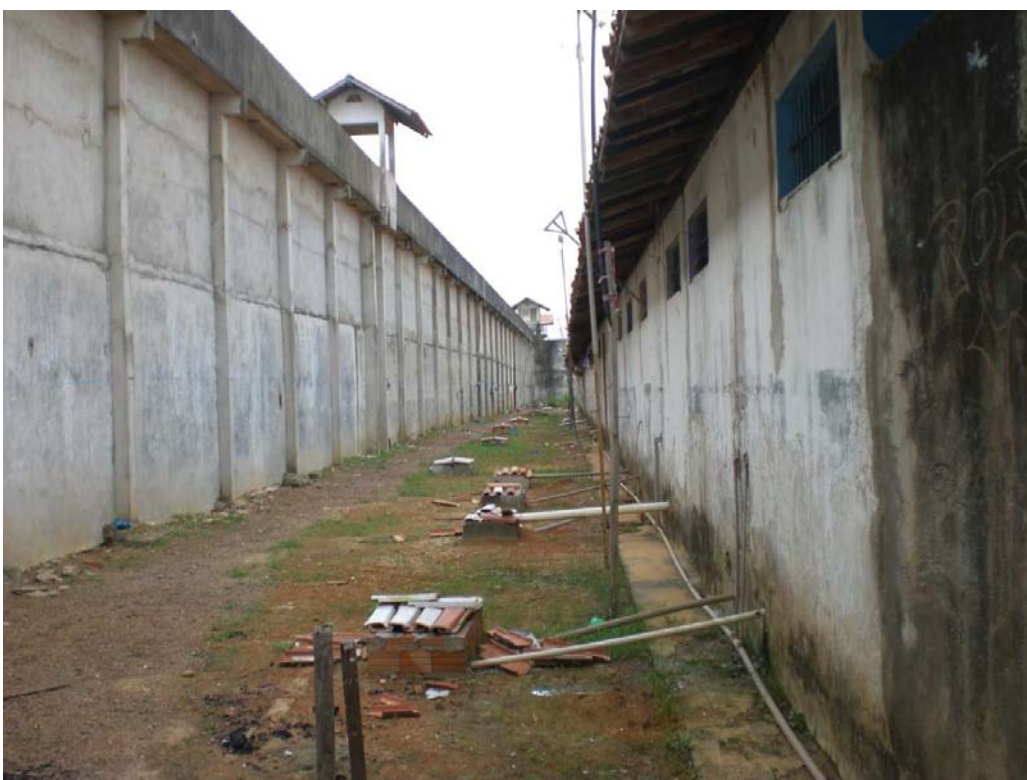
As fossas ao lado das celas – precariedade da vazão de esgoto – cheiro forte
