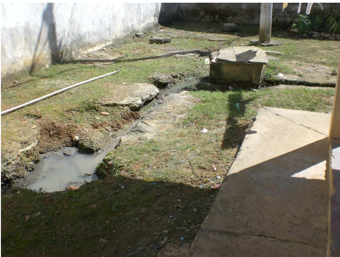
esgoto a céu aberto
