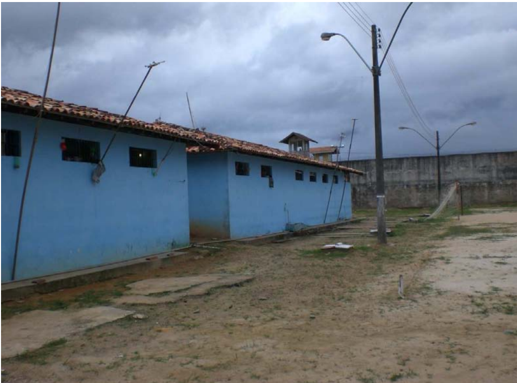
Vista externa de parte das celas - construções em tijolos - fragilidade
