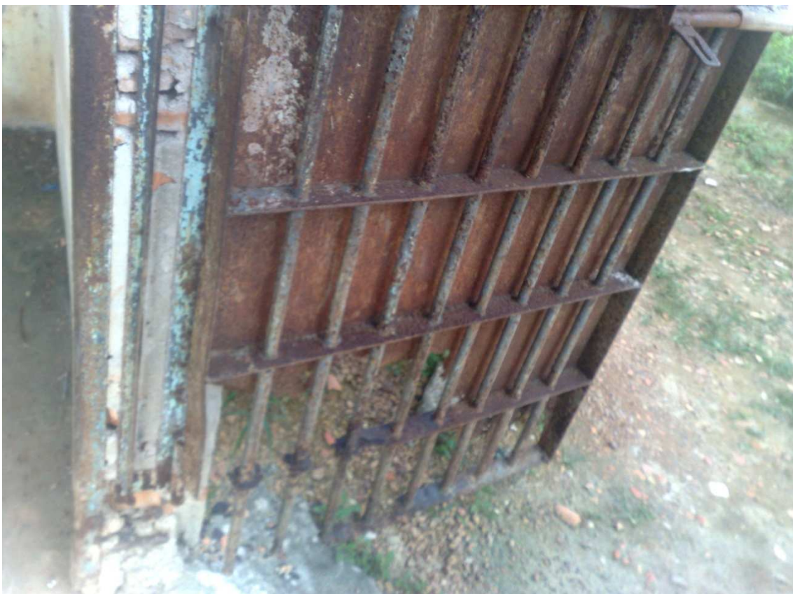
Presídio antigo – deterioração das instalações
