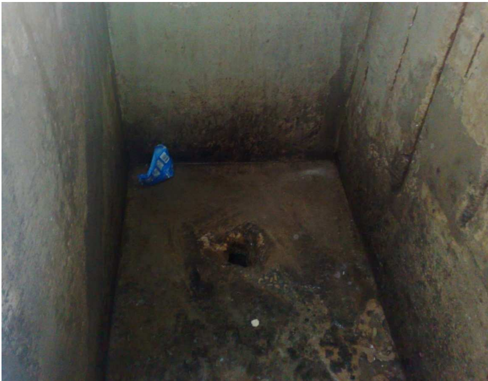
Sanitário das celas em péssimas condições
