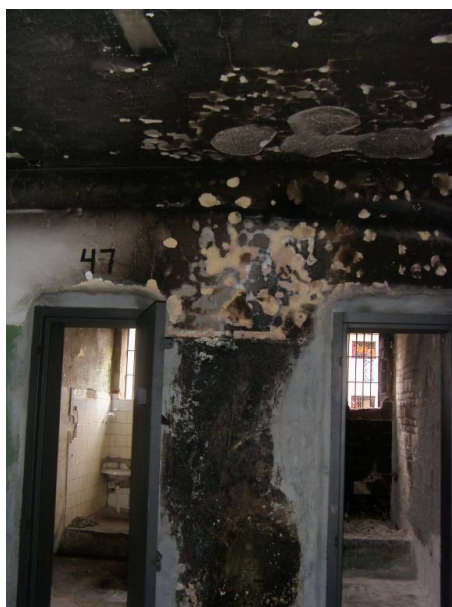
Cela queimada na rebelião e novas portas instaladas após a rebelião
