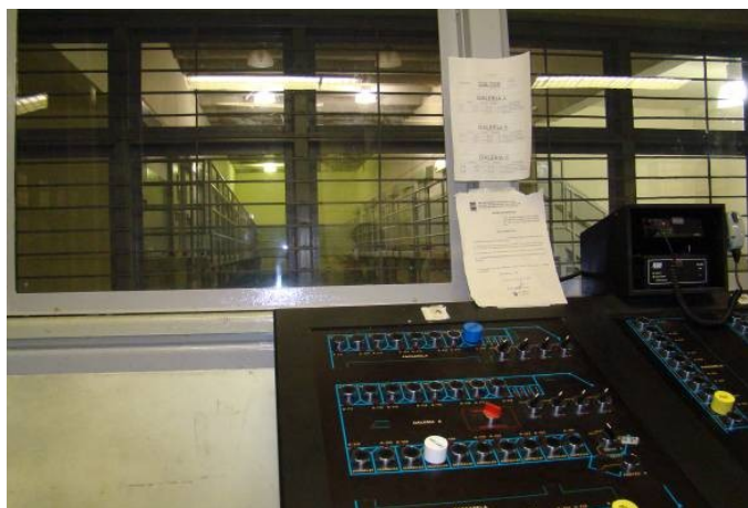
Sala de controle
