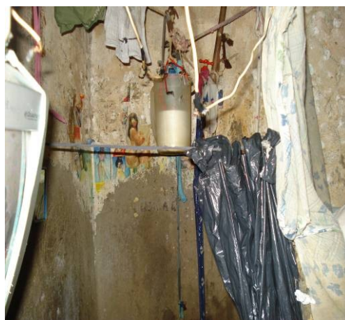
Péssimas condições de higiene e chuveiro improvisado com jarra d'água
