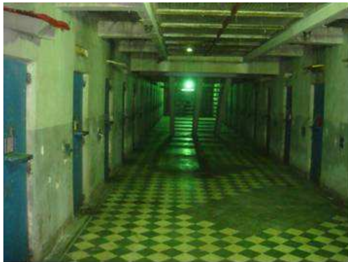
Corredor escuro e celas individuais em mau estado de conservação
