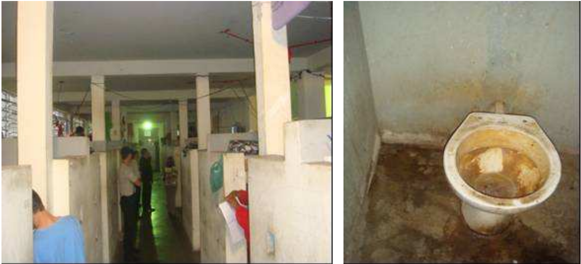
Alojamento mal iluminado e banheiro em más condições
